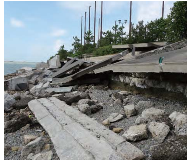
防潮堤損壊 [出典: 大阪湾港湾等における高潮対策検討委員会]
