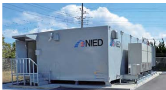
南房総市陸上局 (写真:防災科研)
