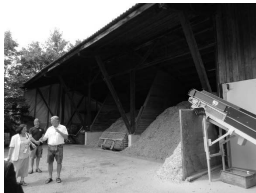
木質チップバイオマスボイラー施設
